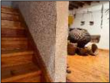
Desconchados y falta de pintura
