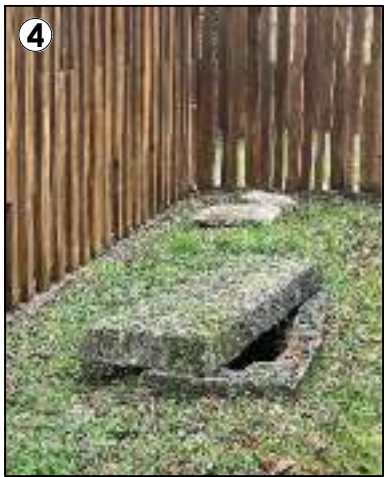
'Tumba' exterior deteriorada
