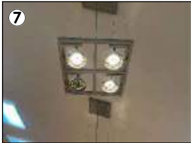
Luminarias existentes fundidas
