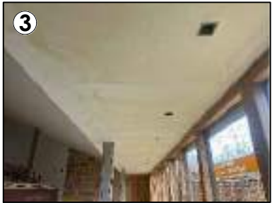
Humedades por filtración de agua desde la cubierta
