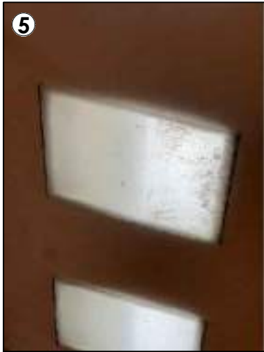
Falta de mantenimiento de lucernarios
