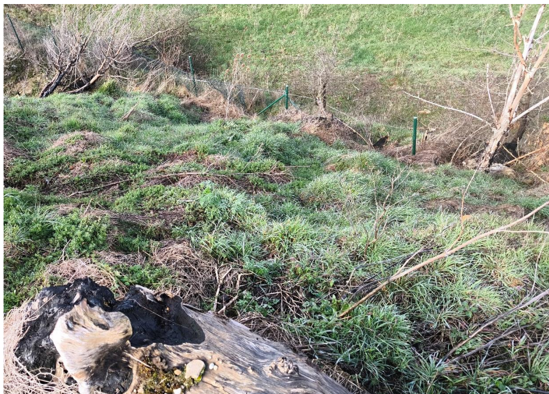
Foto 8. Restos del cierre perimetral, al norte de la parcela.
